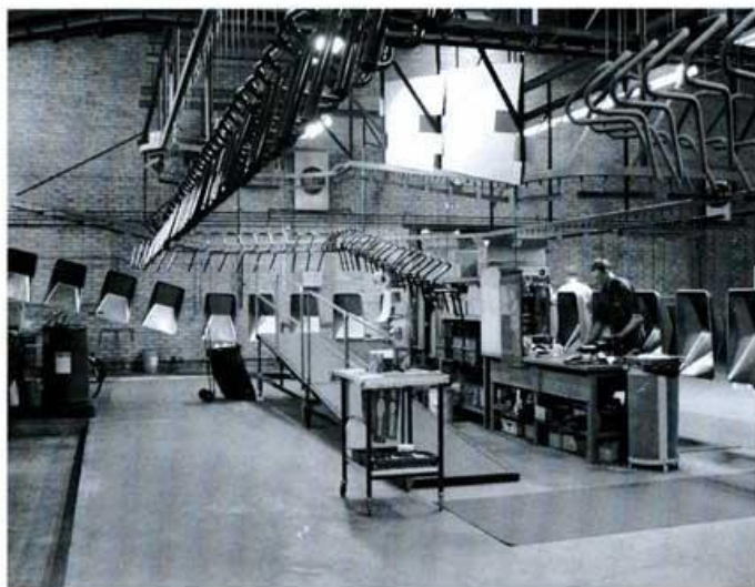
Conveyor anläggning med på- och avplockningsstation.
