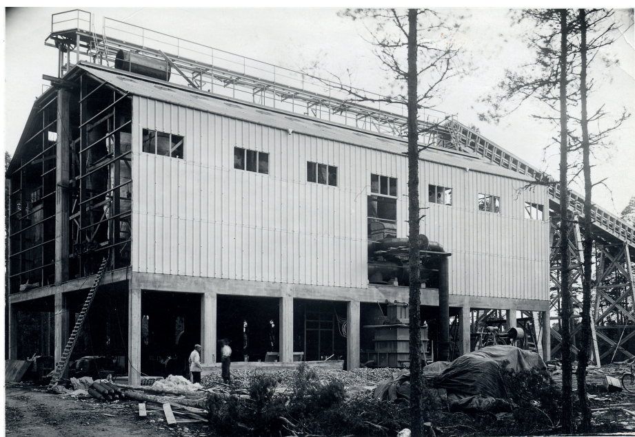
Torvcolsfabriken i Kronoskogen fortfarande under byggnad. I den ofärdiga gaveln till vänster skimtar några av de inalles 24 ugnarna som fabriken innehöll i färdigt skick. Eric Hyttfors arkiv.
